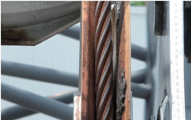
図3 実際の点検画像：ワイヤロープとシーブ Actual inspection images : Wire rope and sheave
