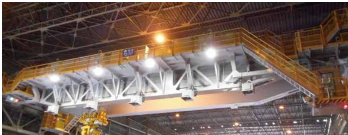
30t×28m天井クレーン 30 t × 28 m overhead crane
