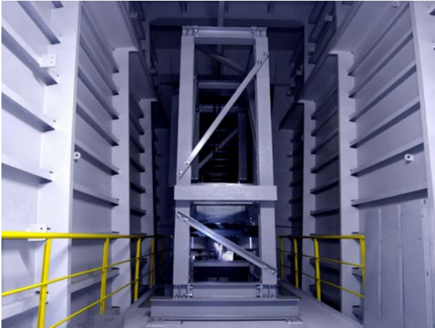
図6 ガーダ内部に設置した制振装置 Tuned mass damper set into girder inside
