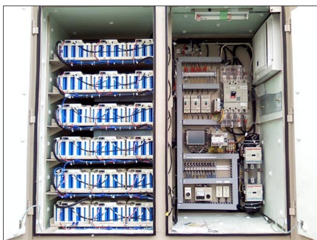
図7 リチウムイオン電池 Lithium-ion batteries
