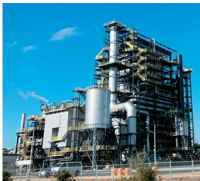
バイオマス発電プラント
