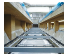
汚泥かき寄せ機
