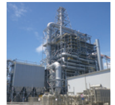
循環流動層（CFB）ボイラ
