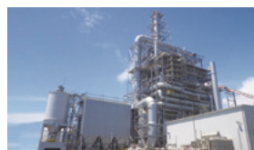
循環流動層(CFB)ボイラ
