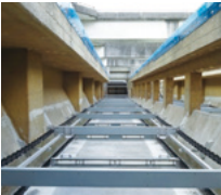
汚泥かき寄せ機
