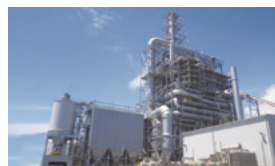
循環流動層(CFB)ボイラ
