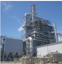
循環流動層（CFB）ボイラ
