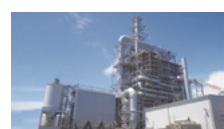
循環流動層(CFB)ボイラ
