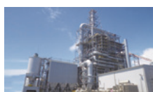
循環流動層(CFB)ボイラ
