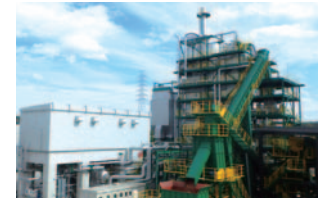
バイオマス発電設備
